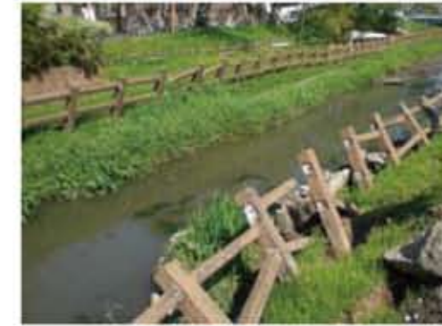
県内各地の液状化被害を現地調査 (香取市)
